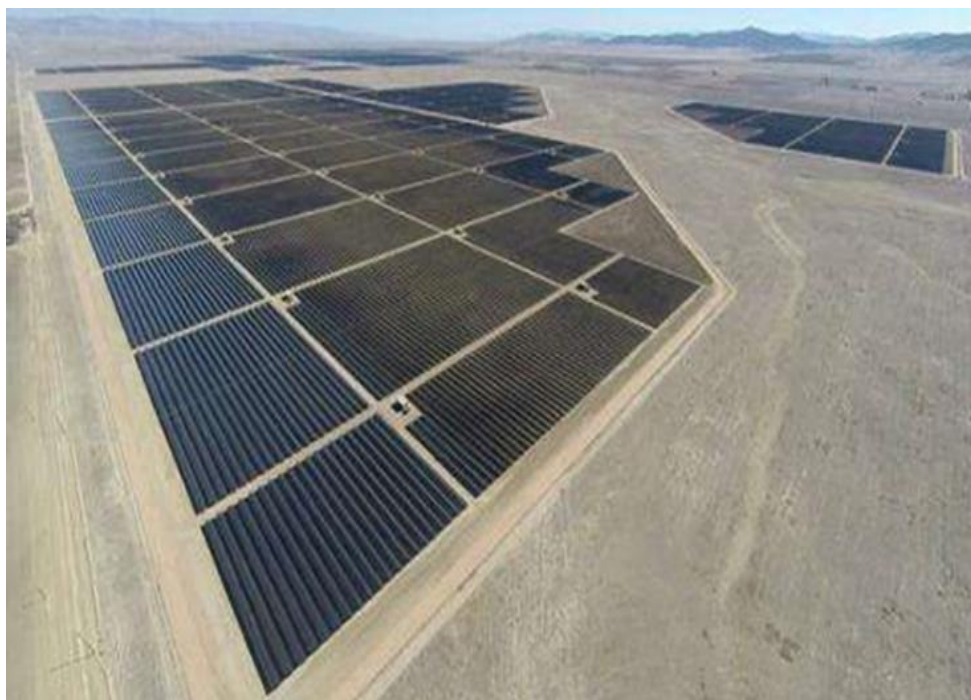
Рисунок 9 – СЭС Topaz Solar Farm
