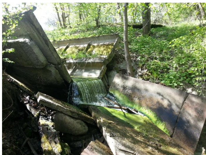
Рисунок 4 – Разрушенный лоток быстротока (2014 г.)
