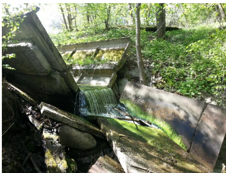
Рисунок 5 - Разрушенный лоток быстротока 2014 г.
